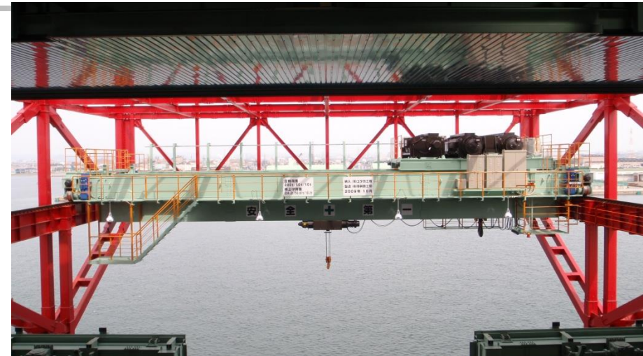
200 t / 50 t / 10 t × 23mホイス式天井クレーン
